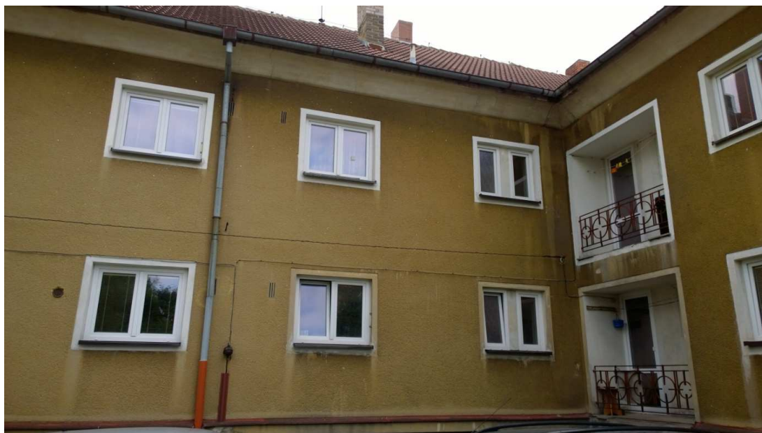
Obr. 31 Severní strana domu s větracími otvory. V rohu domu je patrné také poškození římsy, kde se nachází jeden z přístupových otvorů do podstřeší.
