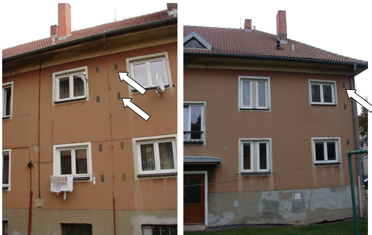
Obr. 2 Pohled na severní a západní stranu domu č.p. 252 – 255, kde se nachází potenciální úkryty netopýrů v dutinách za šterbinovými větracími otvory u jednotlivých bytů.
