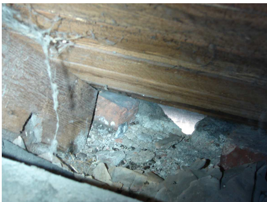
Obr. 23 Pozůstatky hnízdění rorýsů pod okrajem střechy za pozednicí.
