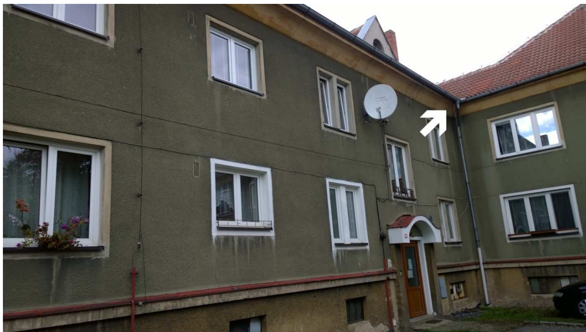
Obr. 84 Šipka ukazuje prasklinu atiky a prostupné místo do prostoru za pozednicí
