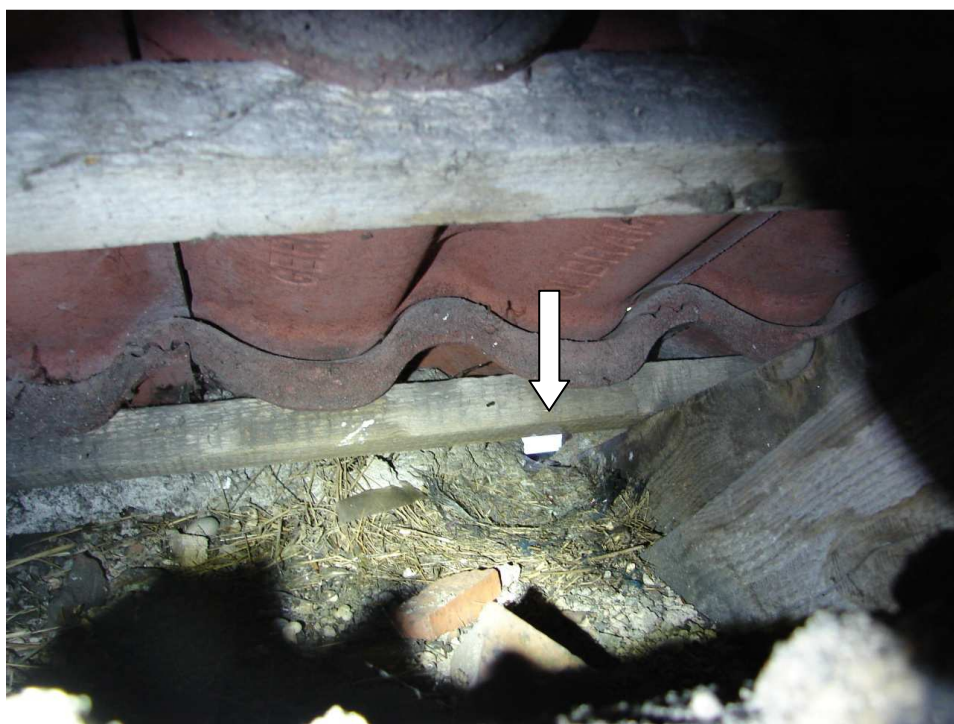
Obr. 41 Hnízdní kotlinka rorýse za pozednicí, patrný je též vletový otvor pod okrajem střechy.
