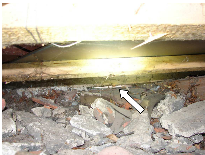
Obr. 16 Šterbina v jihozápadním rohu č.p. 260, u níž byly nalezeny známky možného hnízdění ptáků (peří, trus).
