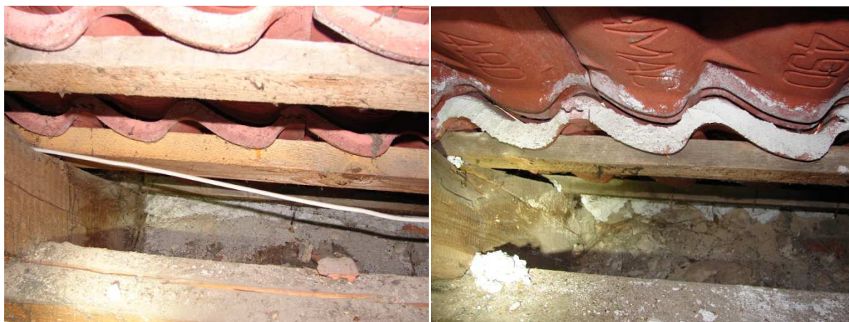
Obr. 92 Zcela zaslepený a zvenku nepřístupný prostor mezi pozednicí a okrajem střechy.
