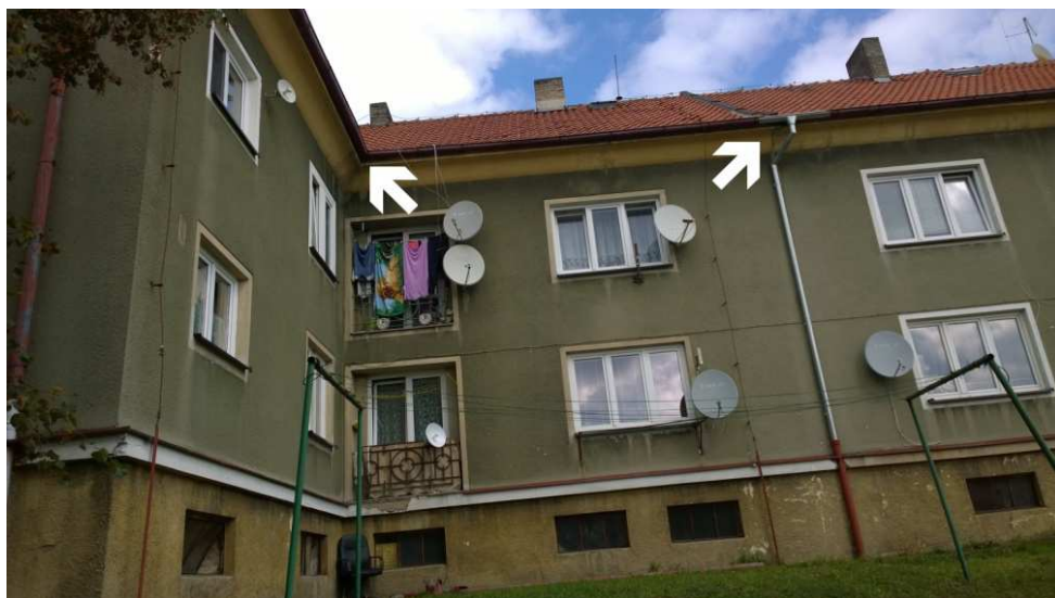
Obr. 36 Jižní stěna budovy, šipky ukazují místa s výrazným poškozením atikové římsy.
