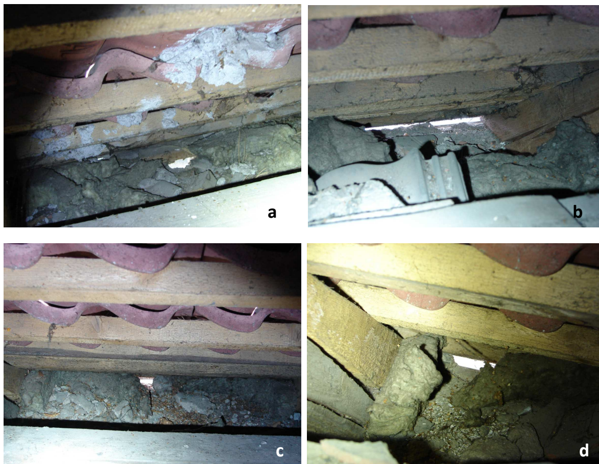
Obr. 10 Místa pod okrajem střecha za pozednicí, kde byla nalezeny přístupové otvory a stopy po hnízdění rorýsů (a, b, c, d).
