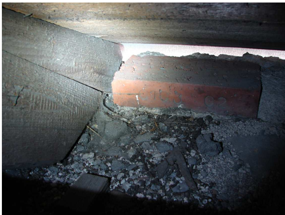
Obr. 22 Pozůstatky hnízdění rorýsů pod okrajem střechy za pozednicí.
