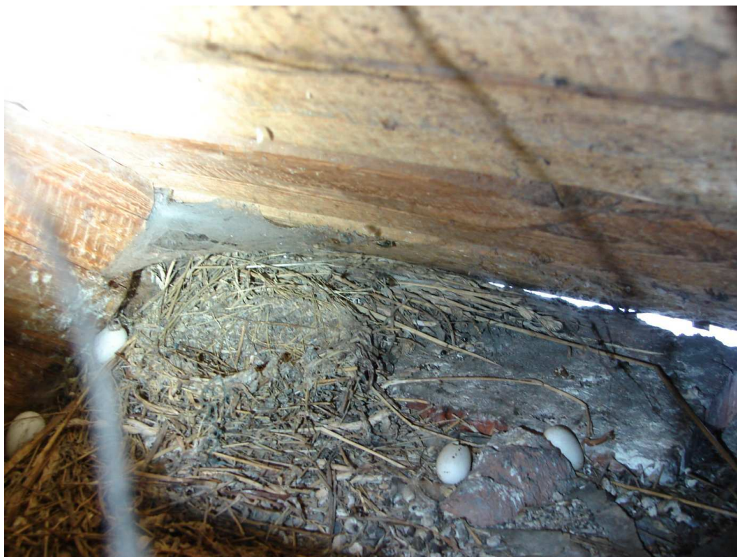
Obr. 25 Hnízdo rorýsů na zbytcích hnízda vrabců pod okrajem střechy za pozednicí, včetně zbytků trusu a vajec.
