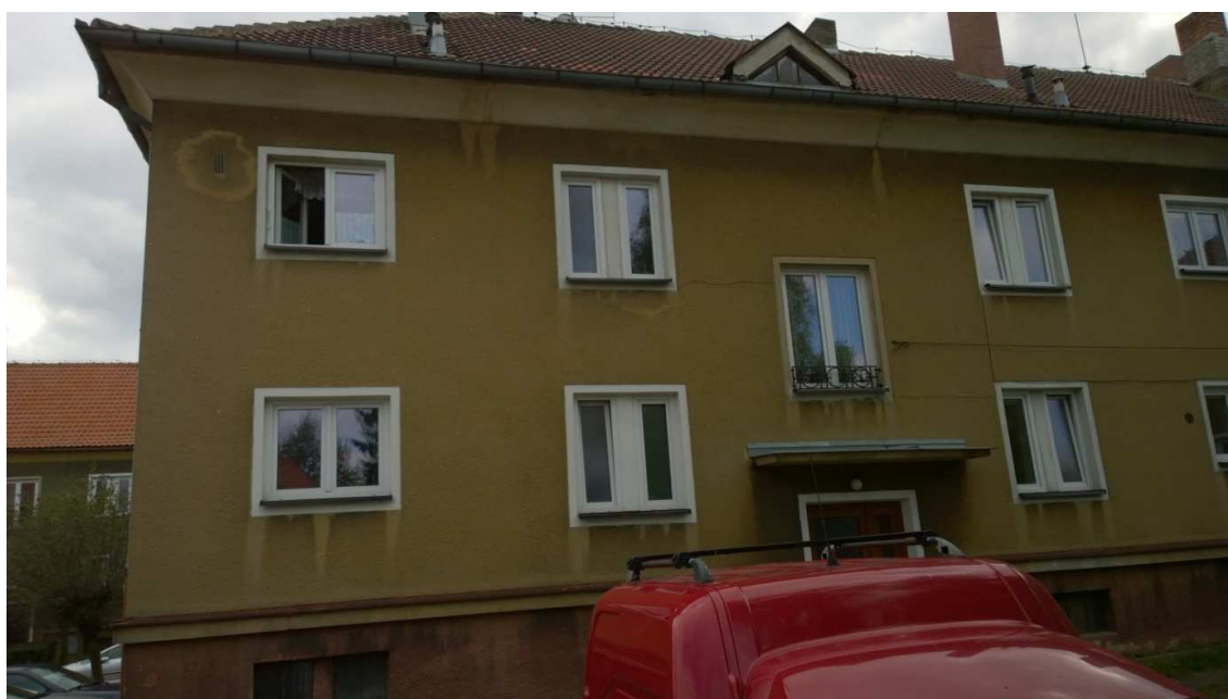
Obr. 32 Severní strana domu. Nad levým horním oknem dle obyvatelky bytu pozorovány zálety rorýsů.
