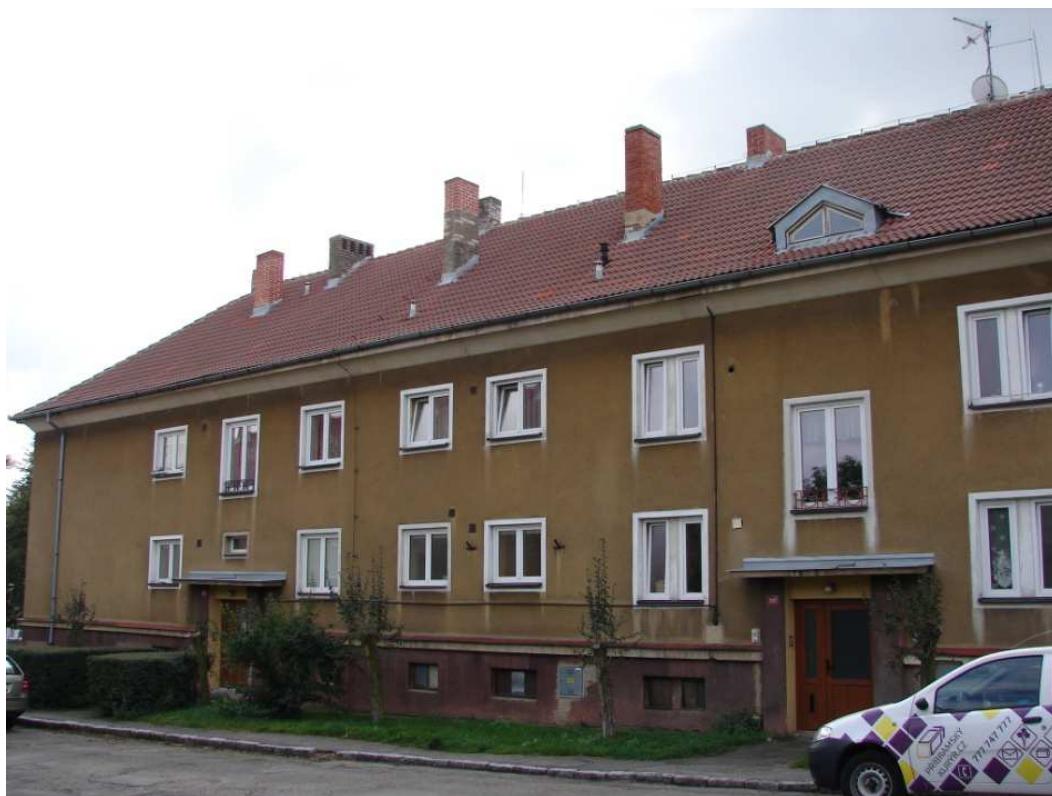
Obr. 67 Severní strana domu s uzavřenými větracími otvory.
