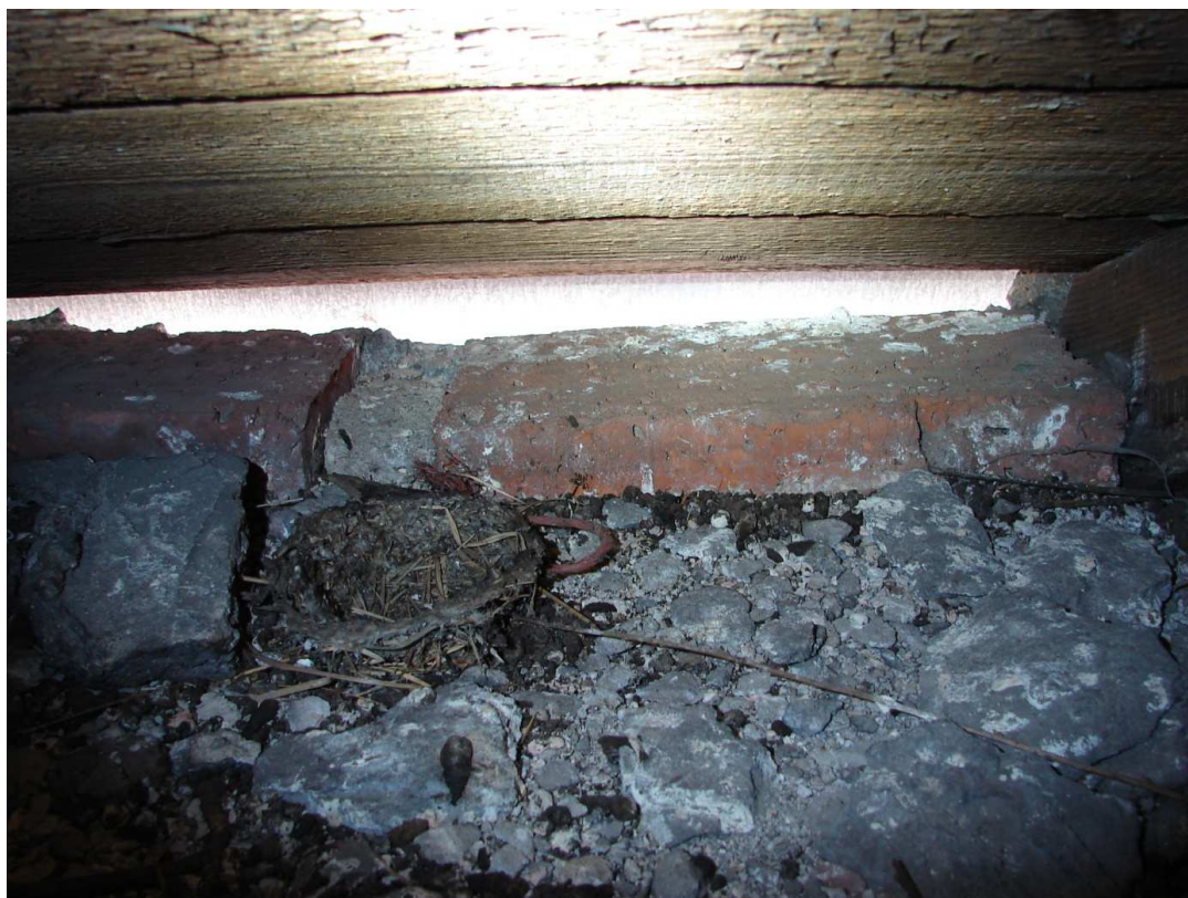
Obr. 24 Hnízdo rorýsů pod okrajem střechy za pozednicí včetně zbytků trusu.
