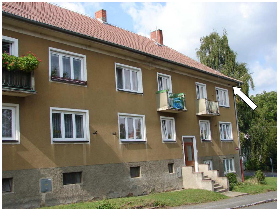
Obr. 12 Východní stěna domu č.p. 260 s hnízdem jiříček obecných pod střešní římsou.
