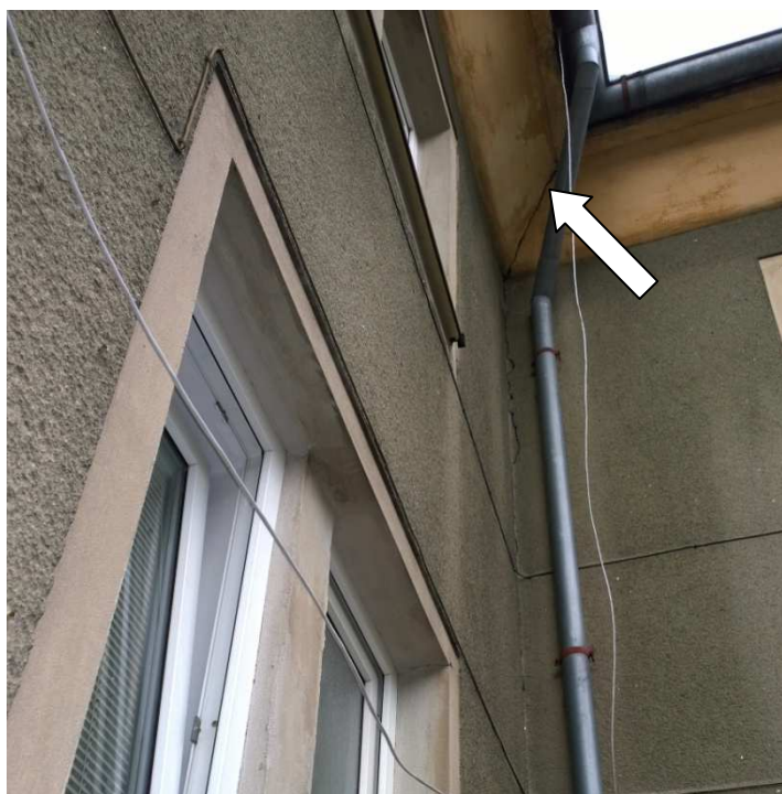
Obr. 85 Detail praskliny v rohu na východní straně budovy – přístupový otvor do podstřeší.
