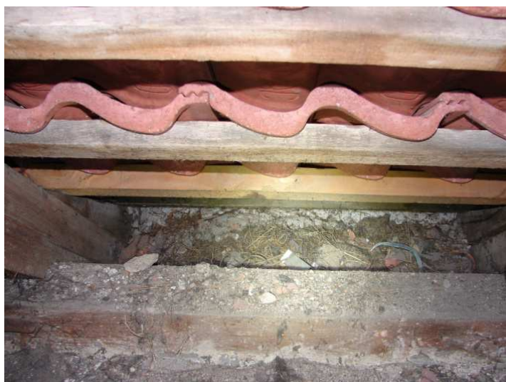
Obr. 93 Staré rozpadlé hnízdo vrabců v prostoru mezi pozednicí a okrajem střechy.
