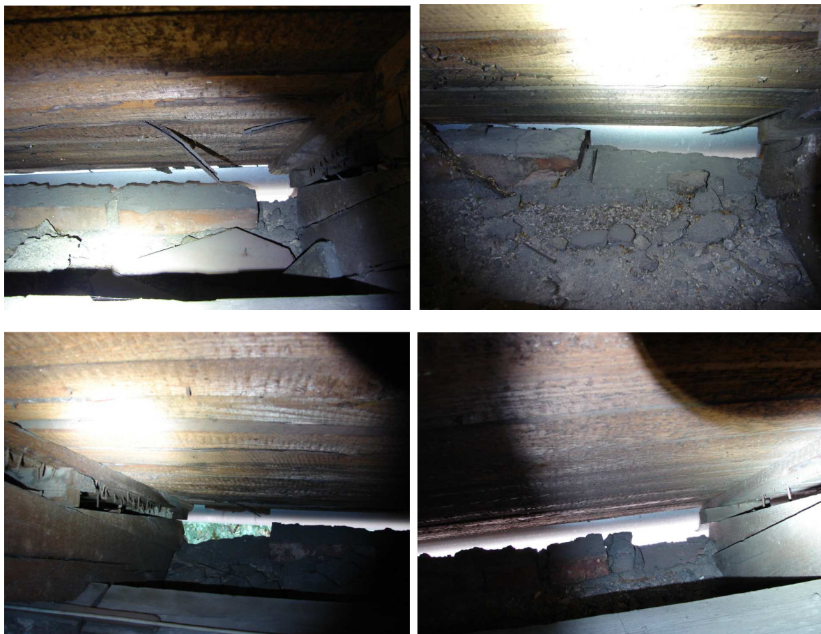
Obr. 30 Místa hnízdění rorýsů pod okrajem střechy za pozednicí. Dobře viditelné jsou vletové otvory ve značně poškozené římse.
