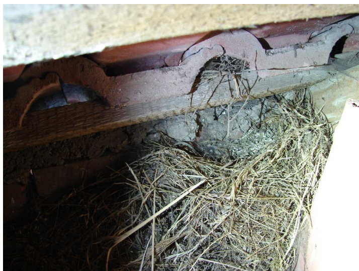
Obr. 47 Trus a hnízdní materiál dokladující nocování a hnízdění drobných pěvců pod okrajem střechy na severní straně domu č.p. 239 a 237.
