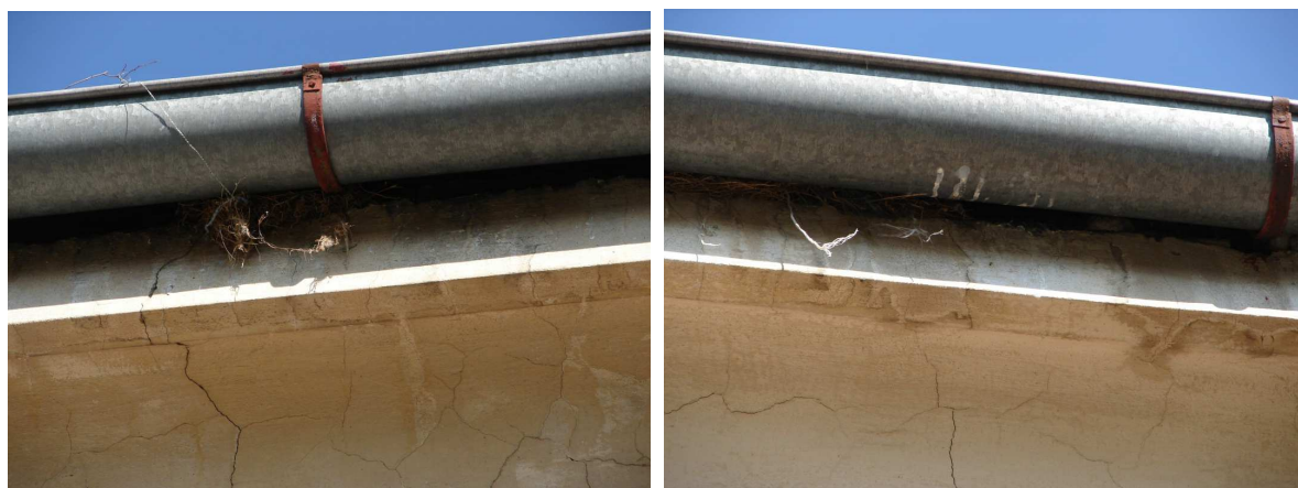
Obr. 39 Materiál z hnízd vrabců vyčnívající z římsy pod okapem na jižní stěně domu.
