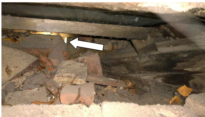
Obr. 82 Prostupné místo za pozednicí na východní straně domu, kde byly nalezeny stopy po hnízdění rorýsů. Šipka označuje vstupní otvor vzniklý v maltě.
