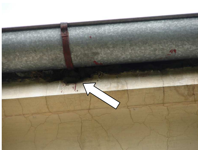
Obr. 79 Pohled na okraj střešní římsy z jižní strany budovy, kde je viditelný ptačí trus a poškození, kudy se ptáci dostávají pod okraj střechy. V tomto místě se nachází jedno z nalezených hnízd rorýsů.
