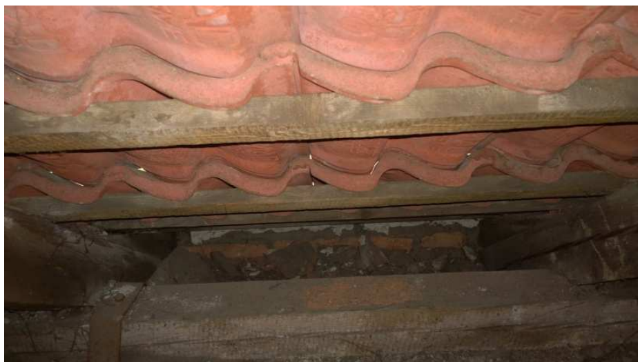
Obr. 90 Zcela uzavřený prostor mezi pozednicí a okrajem střechy.
