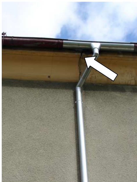
Obr. 35 Potenciální úkryt netopýrů – prasklina v římsce na jižní stěně domu mezi č.p. 217 a 218.
