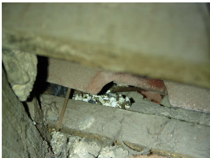
Obr. 49 Hnízdo rorýse pod severním okrajem střechy č.p. 237 (peří a trus).
