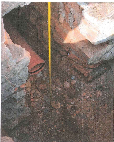
Prostup kanalizace do azylového domu
