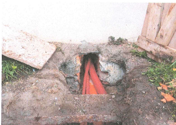
Prostup kanalizace do azylového domu
