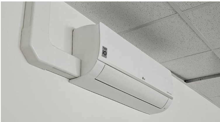
Obrázek 6: Vnitřní klimatizační jednotka (administrativa)
