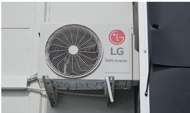
Obrázek 7: Vnější klimatizační jednotka (administrativa)
