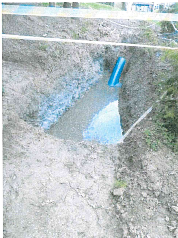
6/ Zatažené potrubí ve skalním prostředí
